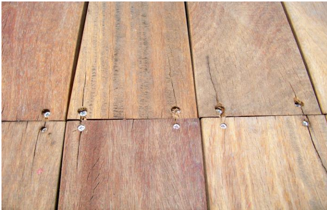
Instalación incorrecta con tornillo visible
